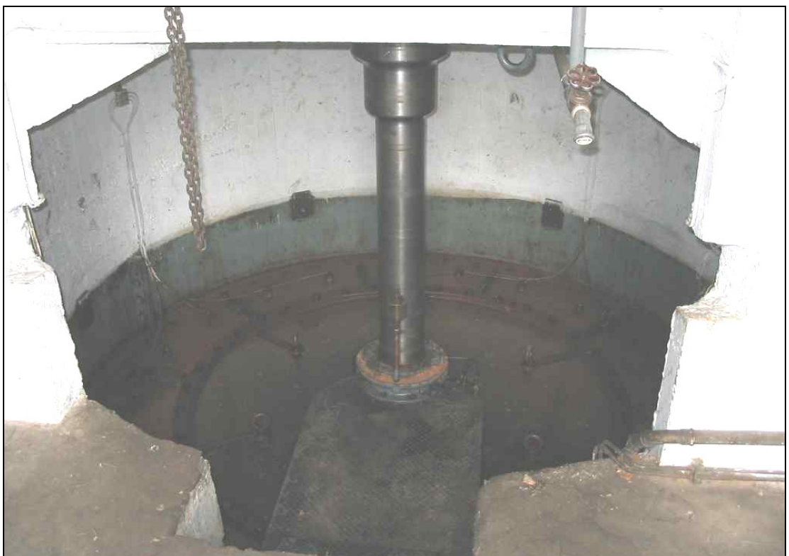
Abb. 9: Die vertikale Kaplan-Turbine des Wasserkraftwerks Widdert (Photo: DUMONT & BAUERFEIND 2006)
