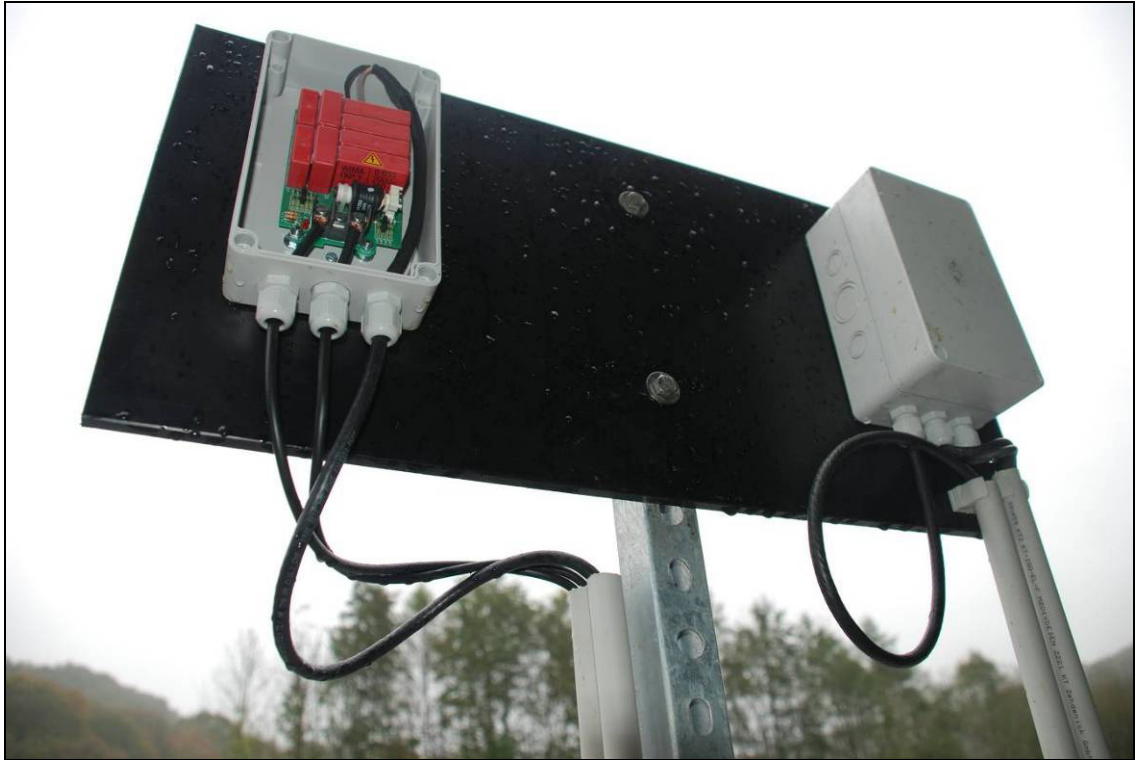
Abb. 24: Hochwassersicher aufgeständerte Tunerboxen; links mit geöffnetem Deckel
