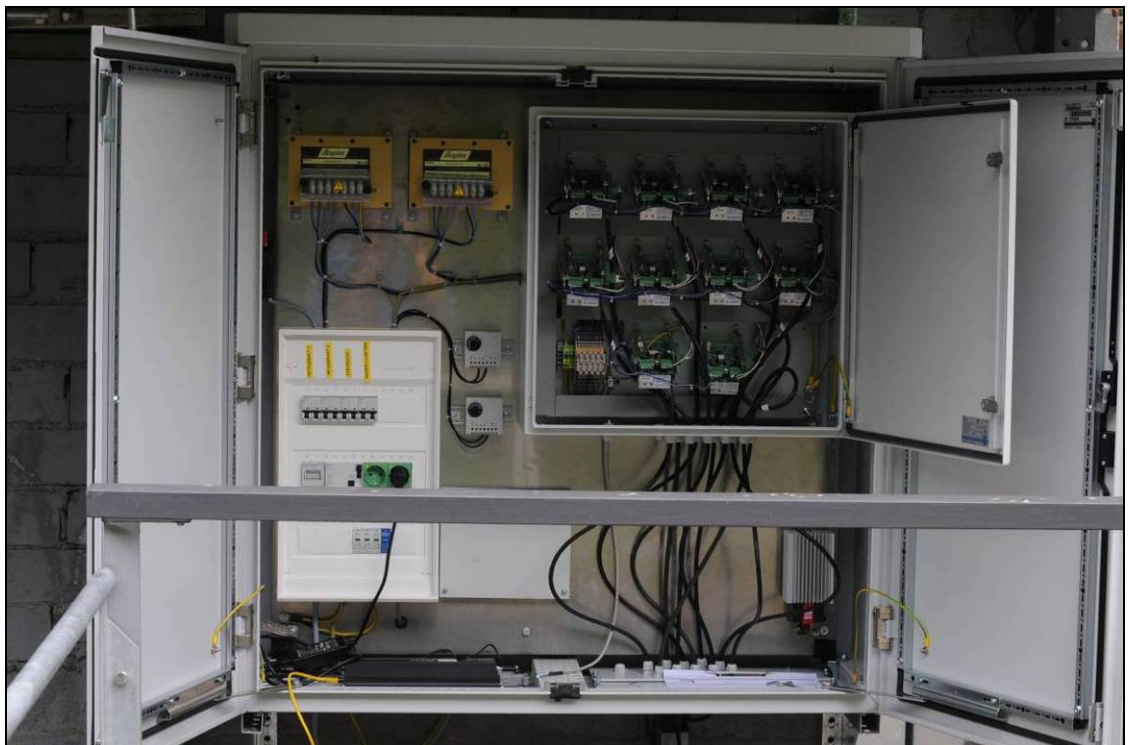
Abb. 25: Schaltschrank am Auer Kotten mit Transformator, Sicherungen, einem PC und den Lesegeräten in einem separat abgeschirmten Gehäuse (oben rechts)
