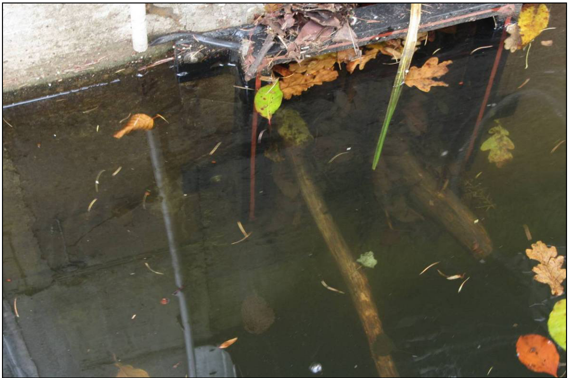
Abb. 49: Dauerhafte Verlegung der oberflächennahen Bypassöffnung durch Äste im Herbst 2013
